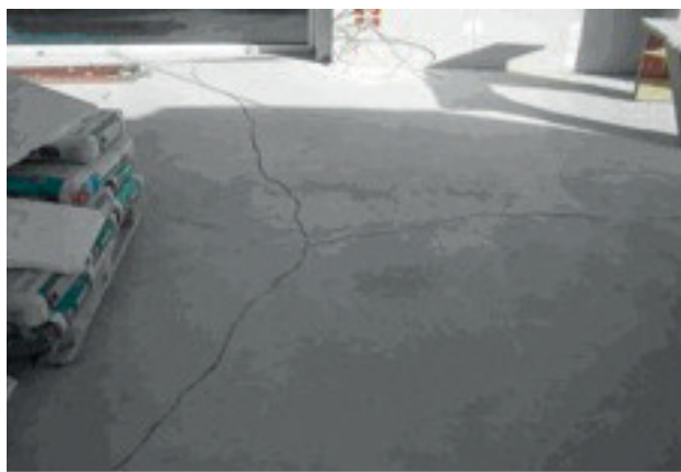
41. ábra A 10 \text{ kN/m}^2 megoszló terhelést is előidéző raklapos termékek építésközbéli felhalmozása, kemény kerekű kézi eszközzel való szállítása miatt az úsztatott esztrich megrepedhet
